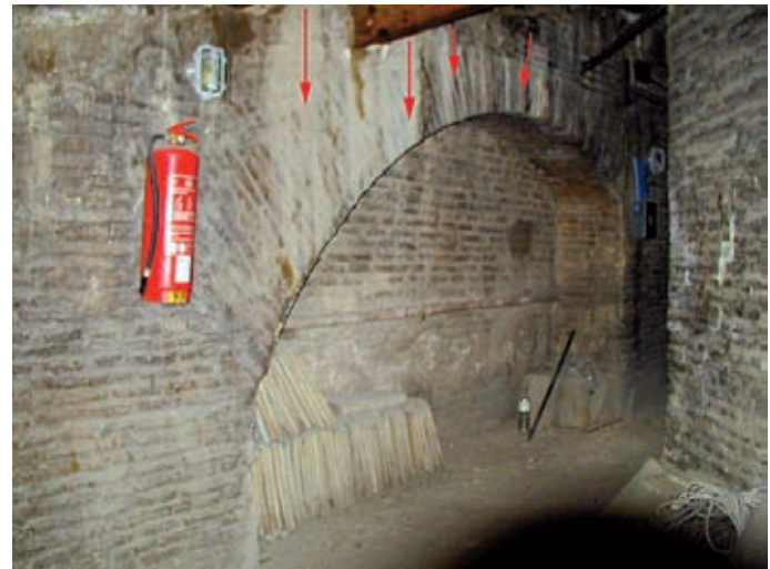
Foto 2. Punto de entrada de agua en el murete perimetral visto desde las falsas de la iglesia. Las flechas rojas indican las líneas de escorrentía.
