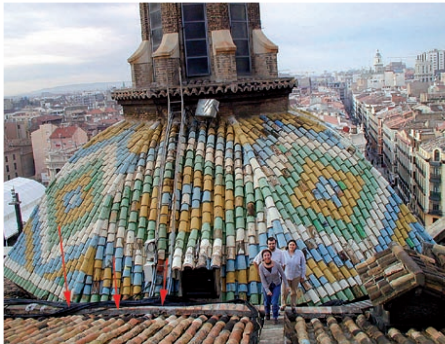
Foto 3. Punto de entrada de agua visto desde cubiertas. Las flechas rojas indican el lugar exacto de intrusión.
